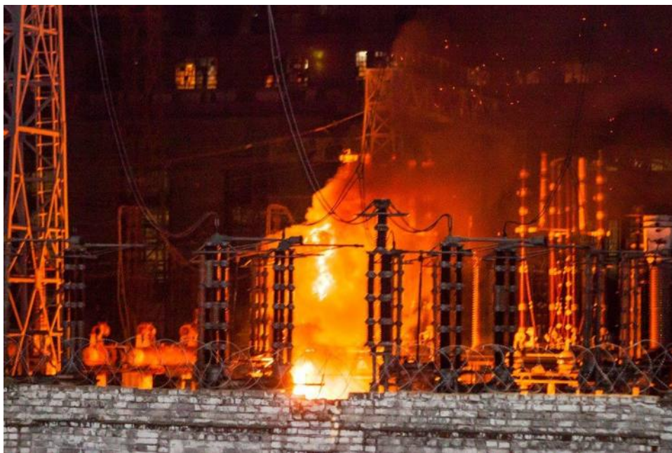
Рис. 4. Пожар на Приднепровской ТС
