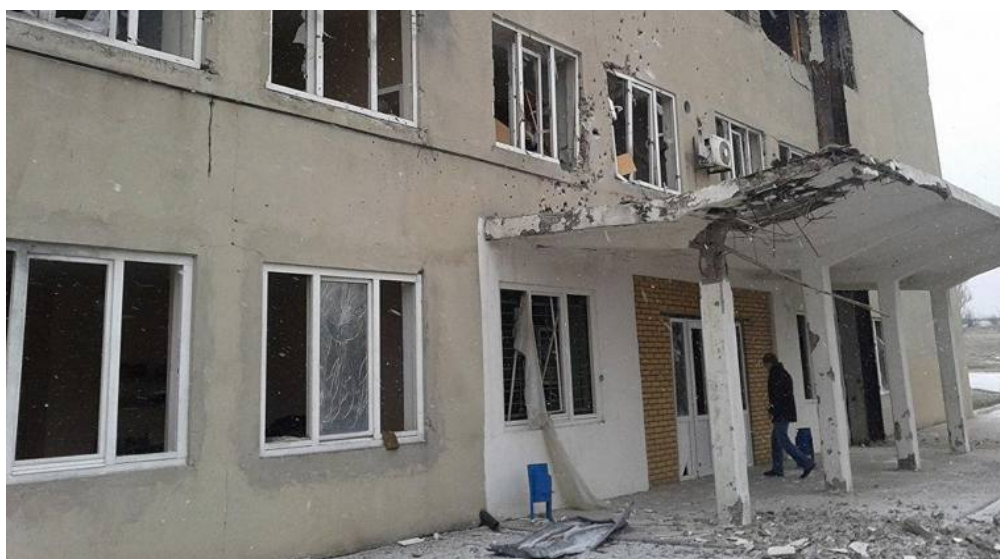
Рис. 2. Последствия обстрела Верхнекальмиусской фильтровальной станции
