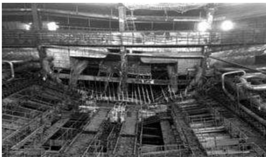
Рис. 2. Последствия пожара на энергоблоке № 3 Березовского ГРЭС
