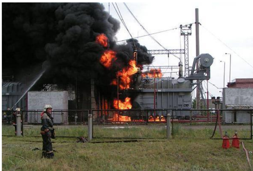
Рис. 1. Пожар на подстанции «Чагино» 2005 г.
