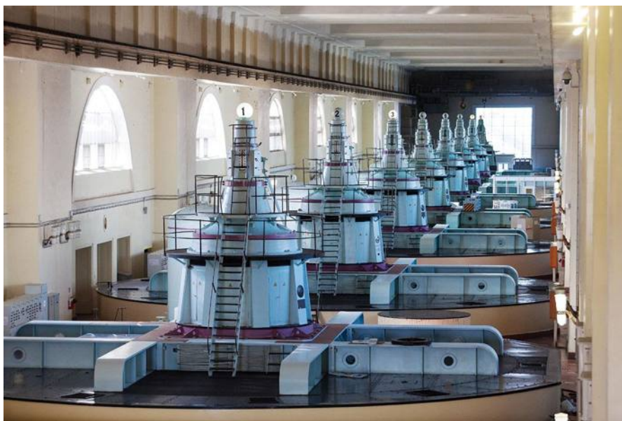
Рис. 1. Машинный зал нижегородской ГЭС
